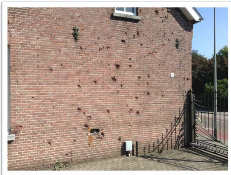
Zijgevel beschadigd door bomscherven
